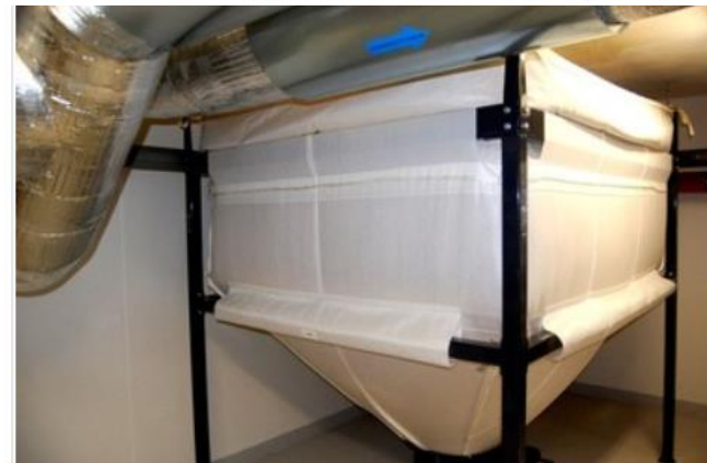
/6/ Hlavní zásobník na dřevěné pelety s automatickým přikládáním paliva
