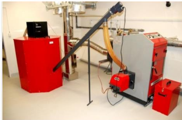
/5/ Hlavní zdroj tepla – kotel značky Atmos na dřevěné pelety
